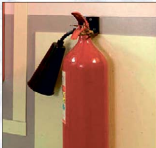
Фотолюминесцентная подложка под огнетушитель
